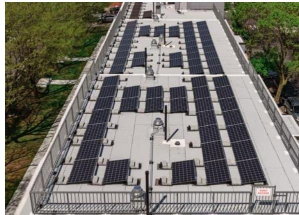
Reparación del tejado y del sistema de paneles solares en Berry St Houses
