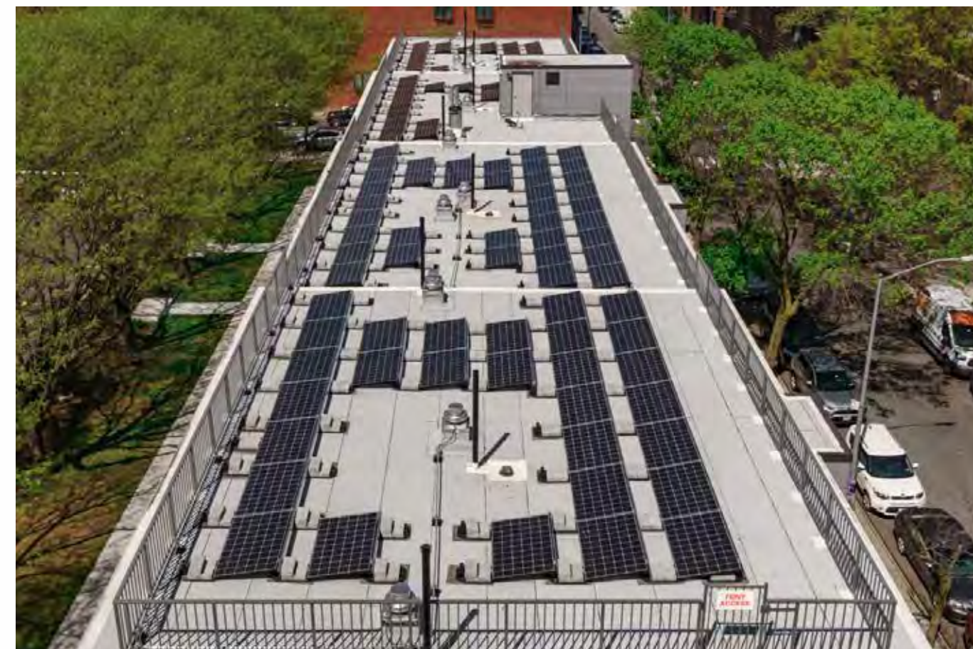
Reparación del tejado y del sistema de paneles solares en Berry St Houses
